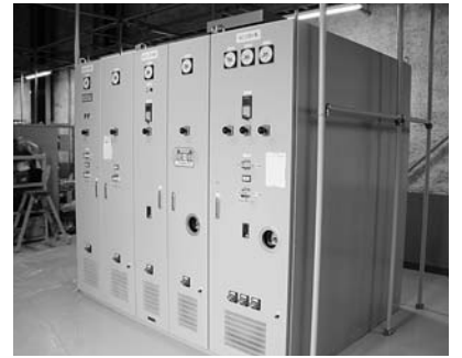
【所内変圧器盤】
