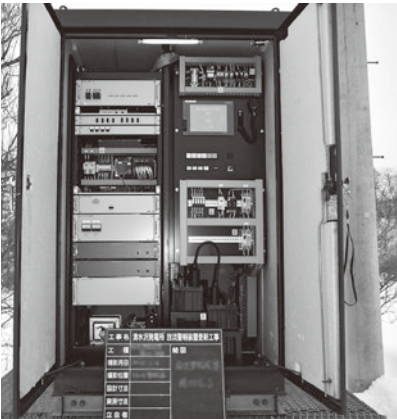
【放流警報装置の内部】
