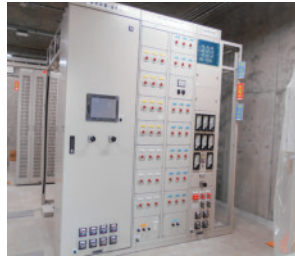
配電盤室の様子
