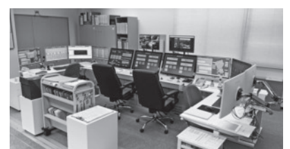
【遠隔ゲート操作卓】
