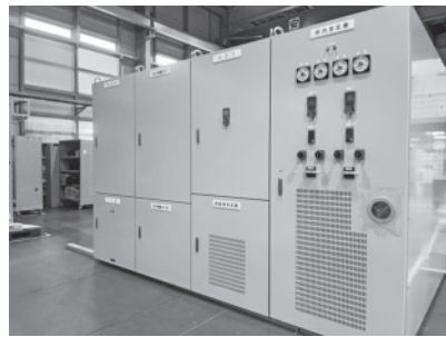
【発電用キュービクル】
